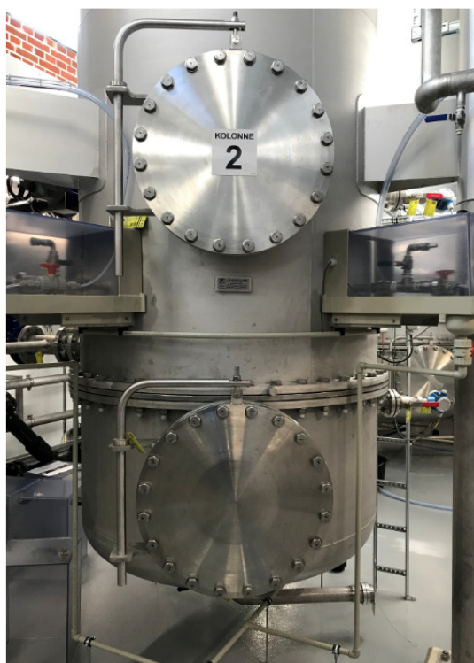
Figur 8-1: Demonterbar endebund og mandedæksler med davit.
