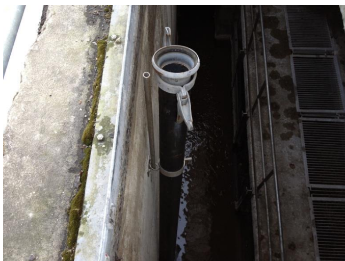
Figur 1 Slamsugerør til sump på større pumpestation
