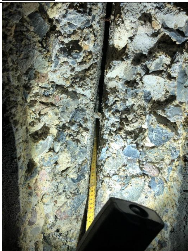
En udrenset dilatationsfuge mod vandbanen
