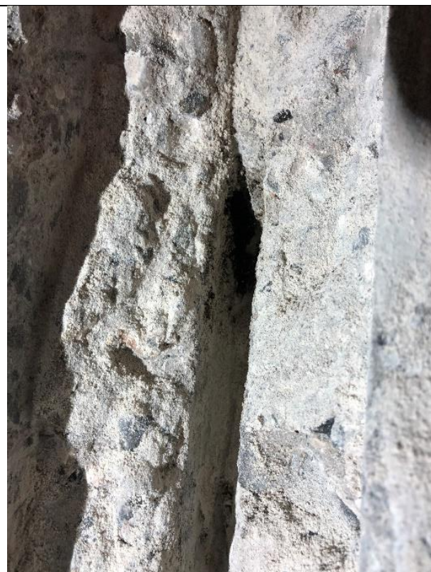
En udrenset dilatationsfuge mod vandbanen
