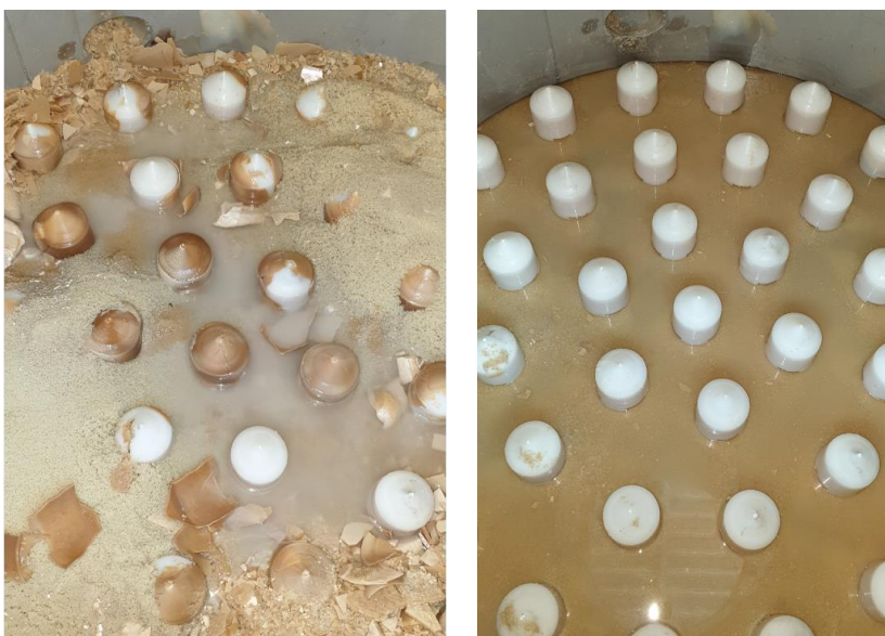
Figur 8 - Dyser inden afrensning for kalkbelægninger (venstre) og (højre) efter rensning
